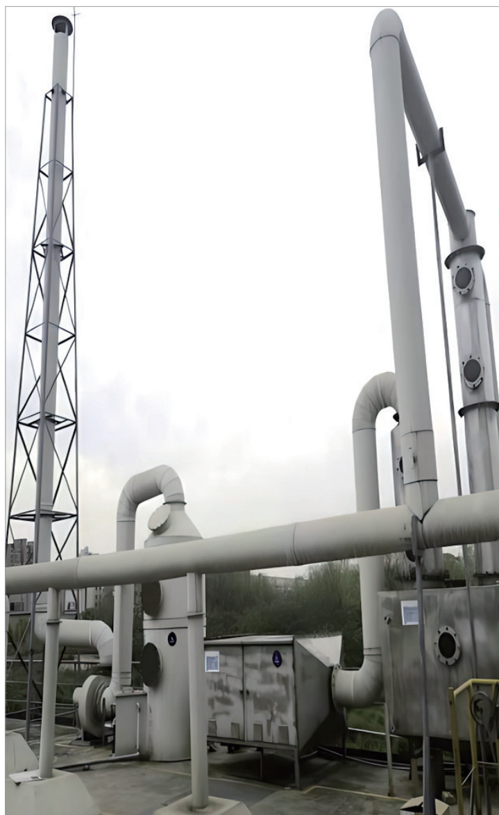
污水站除臭系统
