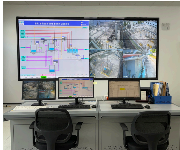
污水在线监控室
