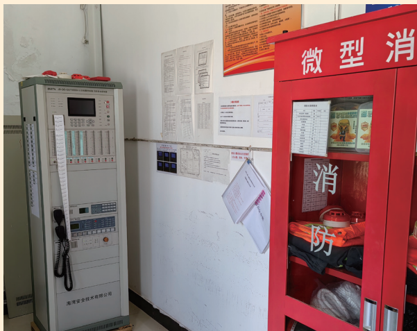
消防应急器材柜
